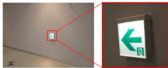
通路誘導灯 (廊下・通路)
