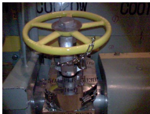
原子炉再循環系ドレン弁（B系）
