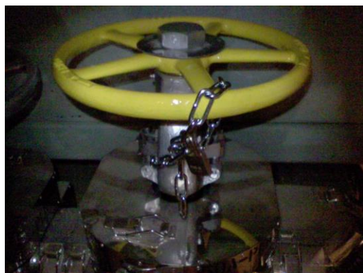
原子炉再循環系ドレン弁（A系）
