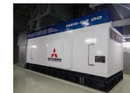
(常設代替交流電源設備の写真)
