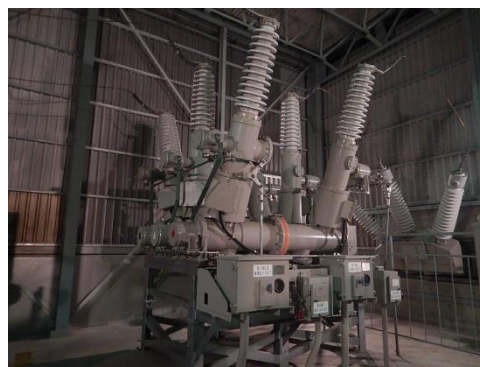
ガス絶縁複合開閉装置（66kV）
