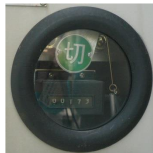
断路器開放状態
