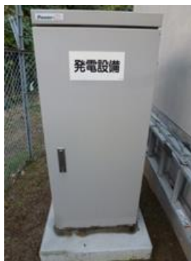
(非常用発電機の写真)
