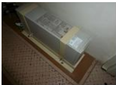
(無停電電源装置の写真)
