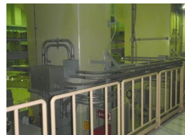
電線管及び端子箱
