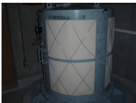
B-非常用ディーゼル発電機 給気消音器フィルタ
