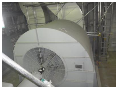
Bー非常用ディーゼル発電機室送風機及びケーブルトレイ
