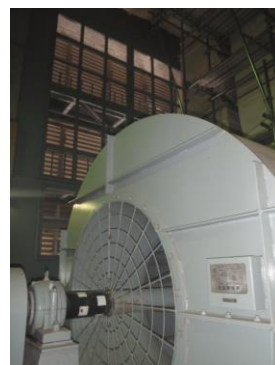
Bー非常用ディーゼル発電機室送風機及び火山灰対策（フレーム）
