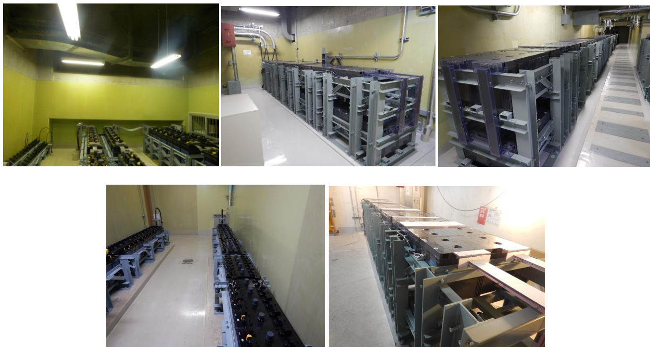
第 41-1-33 図 蓄電池の設置状況 (1 / 9)
