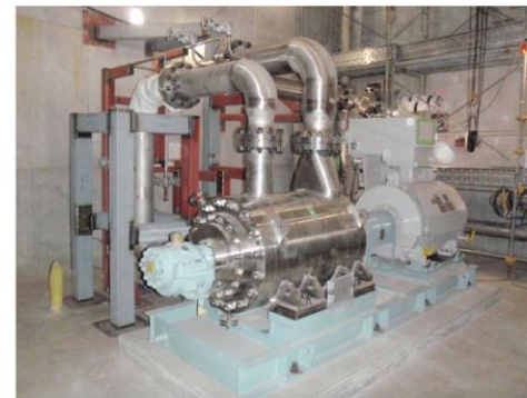
低圧原子炉代替注水ポンプ
