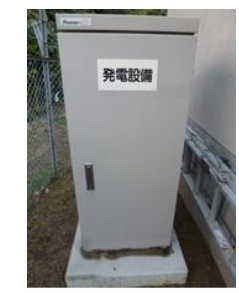
(非常用発電機の写真)
