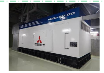
(常設代替交流電源設備の写真)
