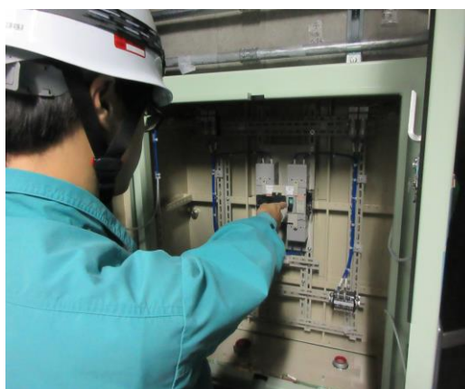
電源切替操作
