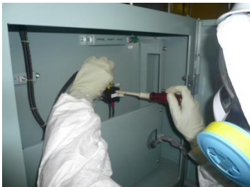
主蒸気逃がし安全弁用 蓄電池へ接続
