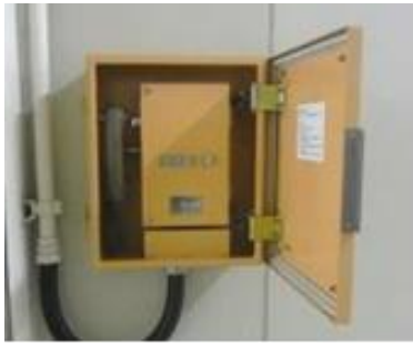
所内通信連絡設備 (ハンドセットステーション)
