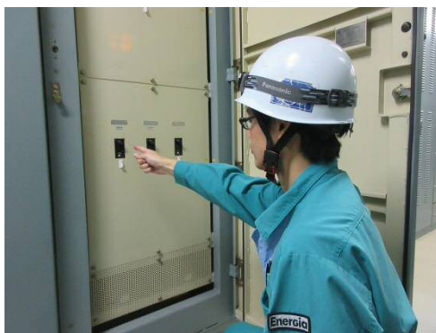
電源切替え操作
