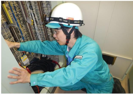
可搬型計測器接続
