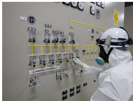
ガスタービン発電機起動操作
