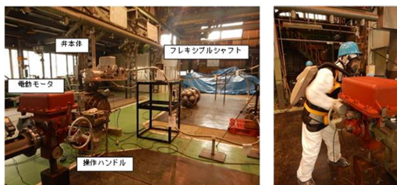
ベント操作（遠隔手動弁操作機構）
