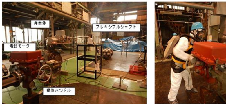
ベント操作（遠隔手動弁操作機構）
