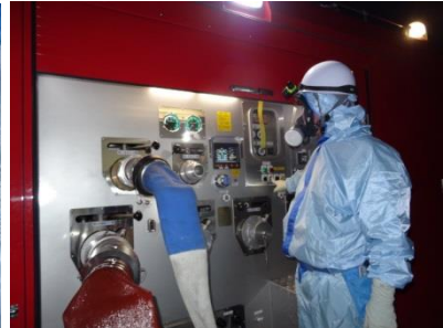
ポンプ起動操作（夜間）
