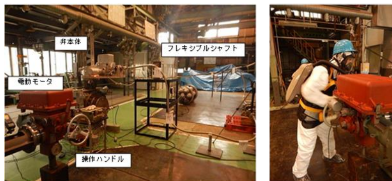
ベント操作（遠隔手動弁操作機構）
