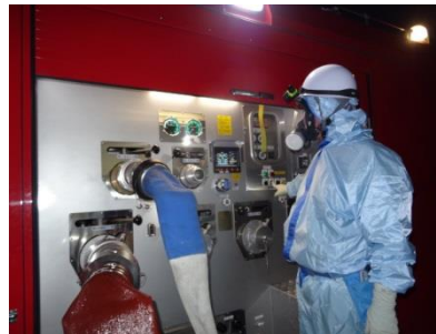
ポンプ起動操作（夜間）
