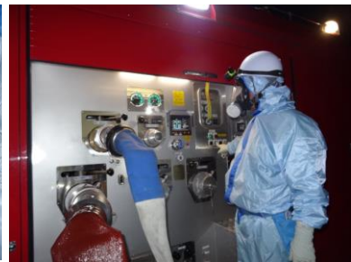
ポンプ起動操作（夜間）
