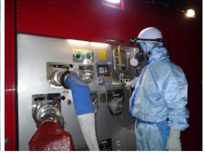
ポンプ起動操作（夜間）
