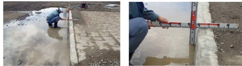
復旧前の段差状況
