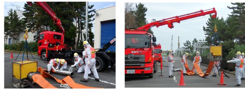
第1.0.13-3 図 放射線防護具類を着用した状態での可搬型代替注水ポンプ車の設置作業
