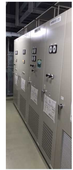
無停電電源装置 (金属製の盤の筐体)
