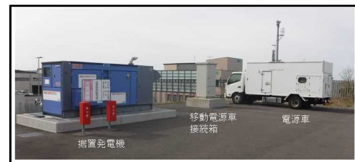
第3-1図 電源車、移動電源車接続箱の設置状況
