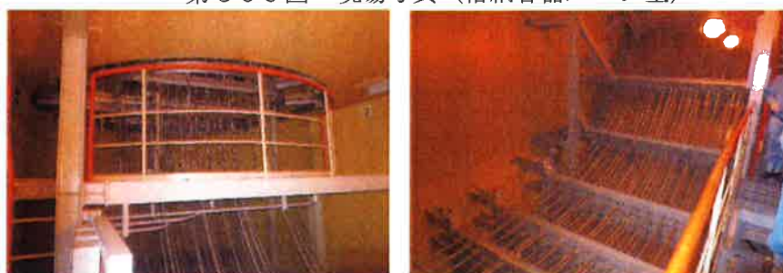
第 3-6-7 図 現場写真 (炉内計装用シンプル配管室内)
