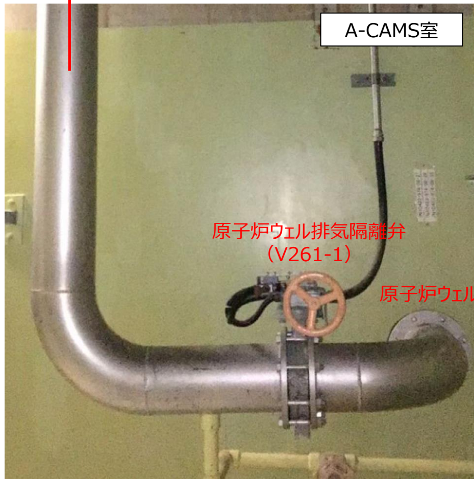
図4 原子炉ウェル排気ラインの現場写真
