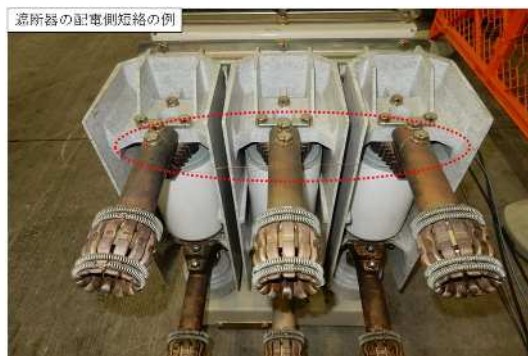
図 4.5.4 遮断器の短絡箇所 (M/C (D/G) 試験時) (非常用発電機に接続される電気盤)
