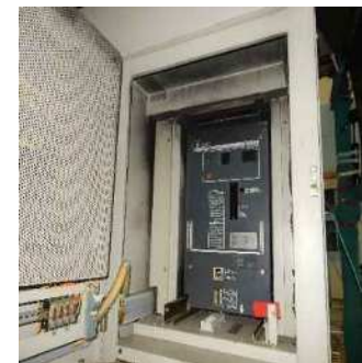
試験後の盤正面の状態
