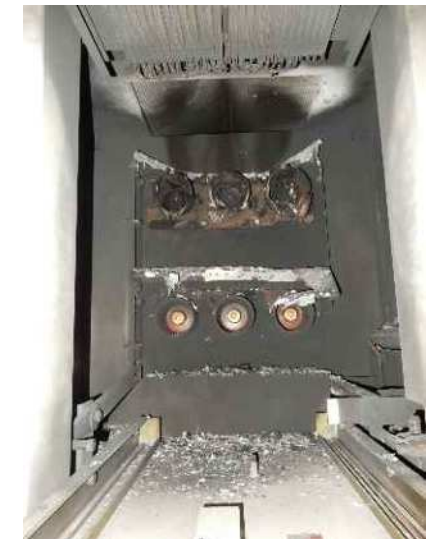
盤内開口部の状態(遮断器室)
