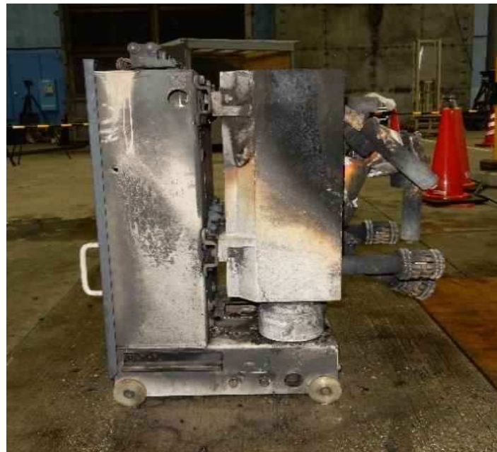
電気盤内遮断器室にてアーク発生、アーク火災有、消火後の遮断器の様子
