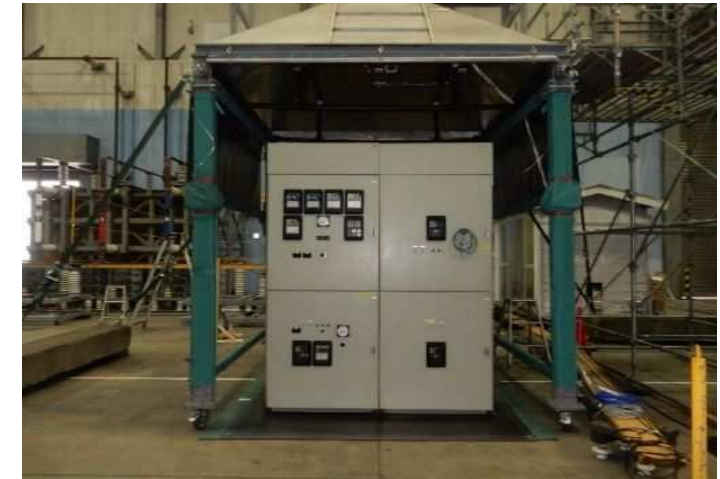
試験状況(M/C(DG)試験時)
