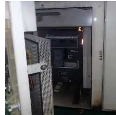
消火前の盤内の様子(盤扉は消火のために手動開)
