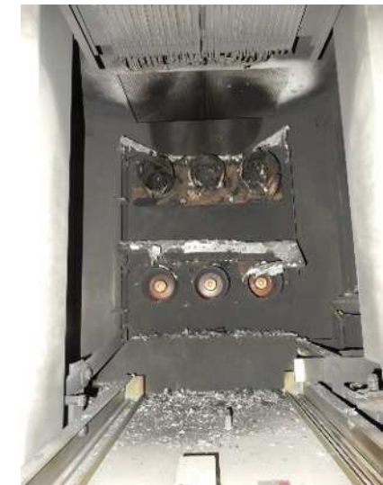
盤内開口部の状態(遮断器室)
