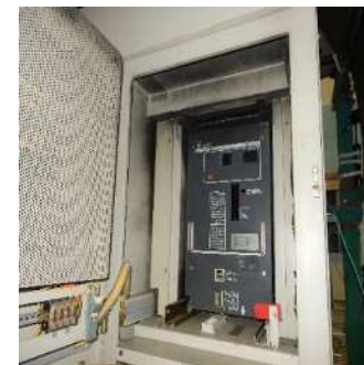
試験後の盤正面の状態
