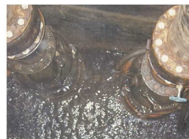
2号炉揚水ポンプの例(揚水井戸⑥)
