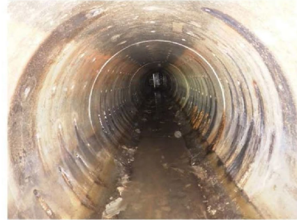
写真A ドレーン(有孔ポリエチレン管φ1,050mm) 2018/9/18撮影
