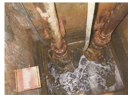
写真D 揚水井戸⑤(下段部) 2017/3/17撮影
