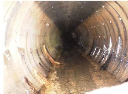
写真B ドレーン(有孔ポリエチレン管φ1,050mm) 2018/9/18撮影
