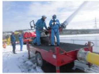
放水砲による放水の状況
