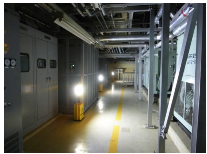
第 3.3-13 図 チェンジングエリア設置場所における可搬型照明 (SA) 確認状況
