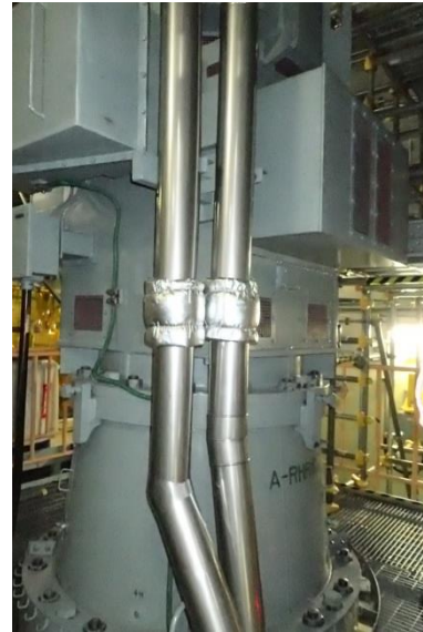
A-残留熱除去ポンプ
