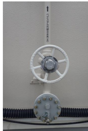
A P F S A-注水ライン流量 調整弁 (V2B6-1A)
