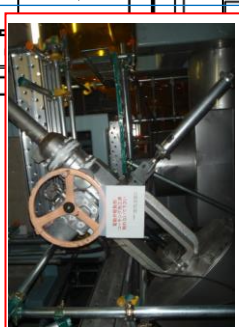
A - RCW常用補機冷却水 出口切替弁 (MV214-3A)
