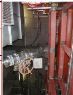
B - RCW常用補機冷却水 出口切替弁 (MV214-3B)
