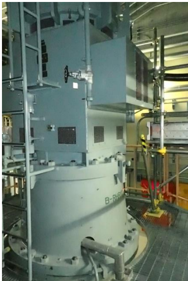
B-残留熱除去ポンプ
