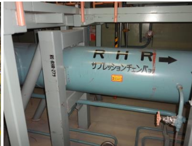
配管及び支持構造
