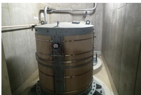
高圧炉心スプレイ系ディーゼル 発電機給気消音器フィルタ
