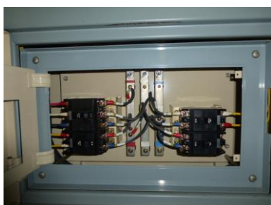
気中遮断器の例 (ブレーカ)
