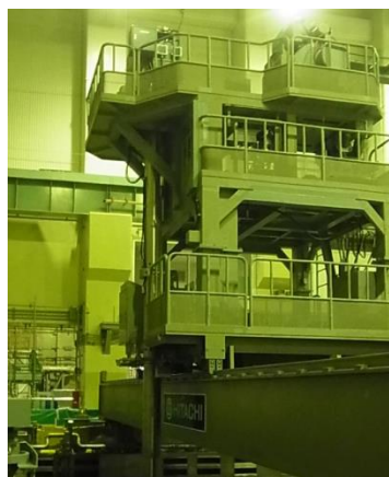
燃料取替機（トロリ）外観
