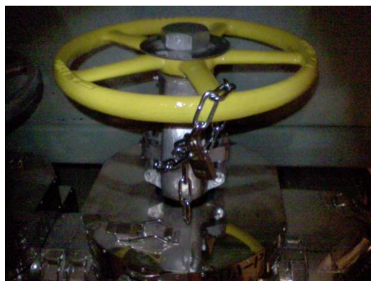
原子炉再循環系ドレン弁（A系）
