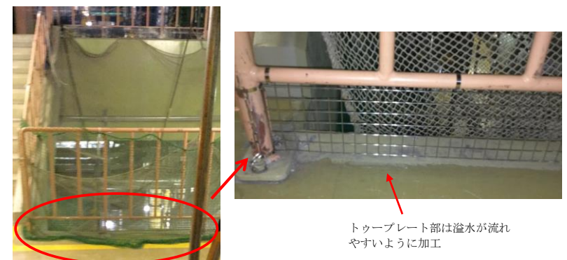
図3 想定した溢水経路に影響を与える可能性のある設備の確認例 (原子炉建物中2階)
