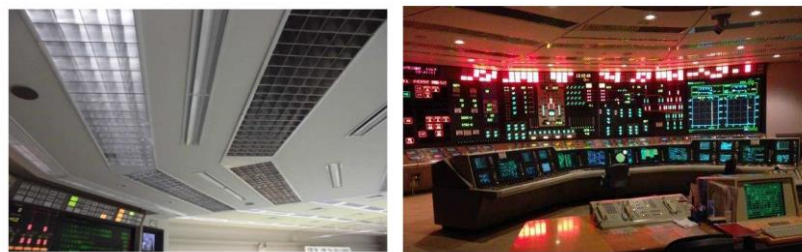
中央制御室照明
