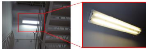
通路誘導灯 (階段)
