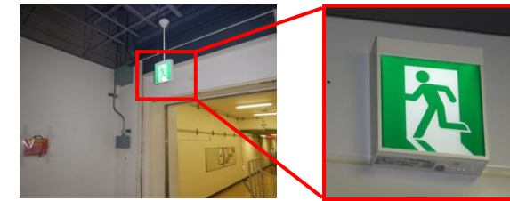
避難口誘導灯
