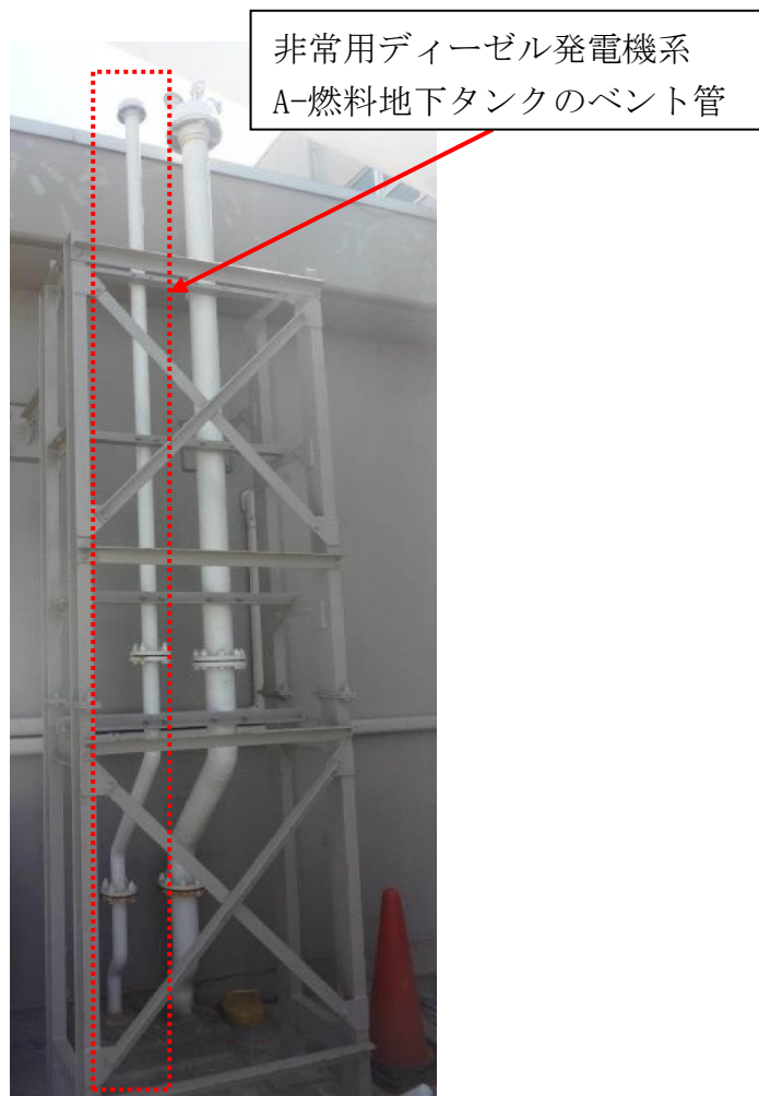
図 2-4 現場確認結果（例）非常用ディーゼル発電機系 A-燃料地下タンクベント管設置箇所 （屋外 EL8500）
