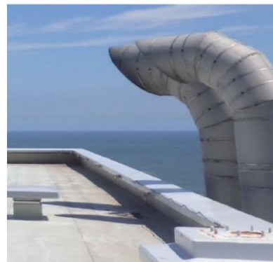
第5図 ディーゼル発電機排気管
