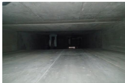
B-非常用ディーゼル発電機 給気消音器フィルタ室内
