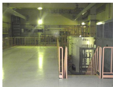
RCW サージタンク及び 計器ラック
