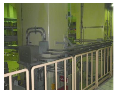
電線管及び端子箱
