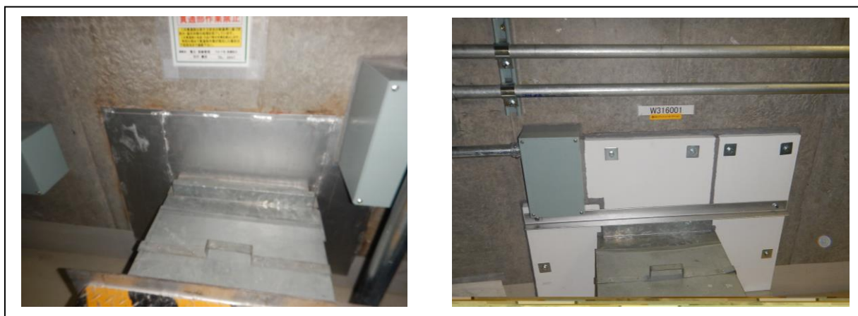
第2図 3時間耐火の貫通部シールを施したケーブルトレイ貫通部の周囲状況
