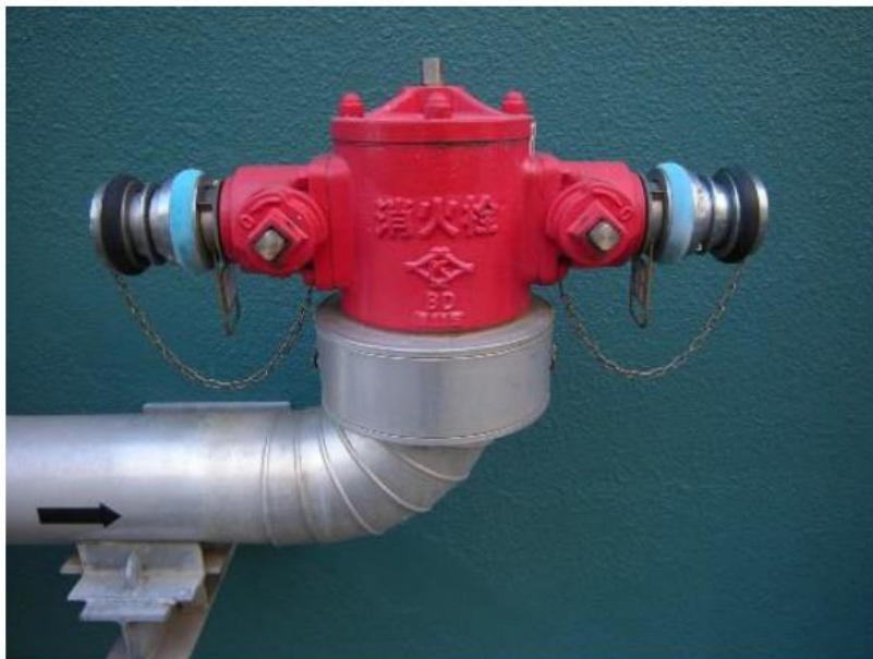
第 1-32 図：不凍式消火栓の設置状況
