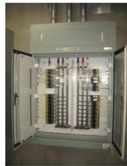
配線用遮断器の例 (ブレイカー)
