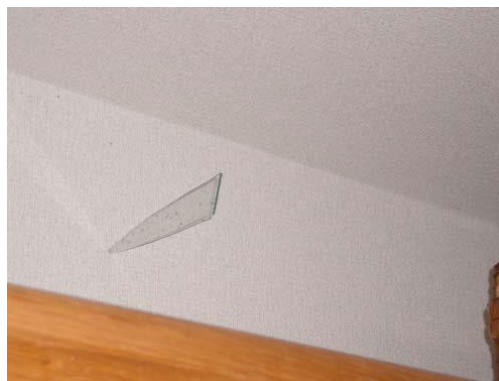
写真 25 破損した窓ガラス片の屋内壁面への突き刺さり[山下町]
