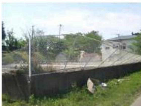
写真3.5-10 フェンスの被害状況
