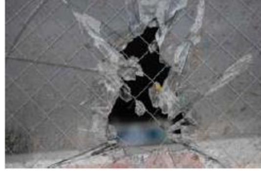
写真 3.4-36 ガラスへの飛来物の衝突痕
