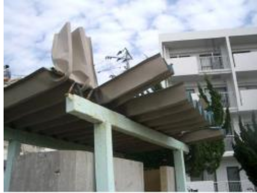
屋外トイレ屋根の損傷
