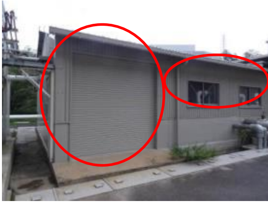
78 1号ろ過水装置建物の西側シャッター，ガラス窓
