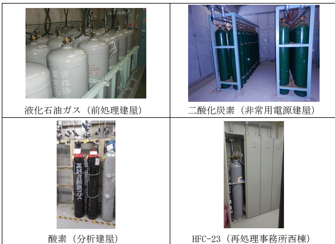
図2 再処理施設における高圧ガス容器の保管状況
