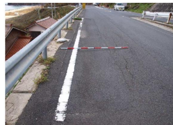
ブロック中央部における路面の変状
