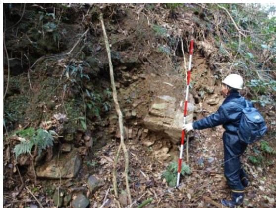
地すべり末端部には土砂が露出している
