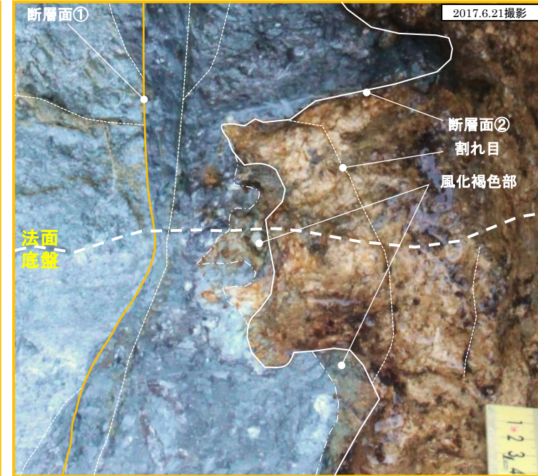
c断層 凹凸部 接写写真(解釈線あり)
