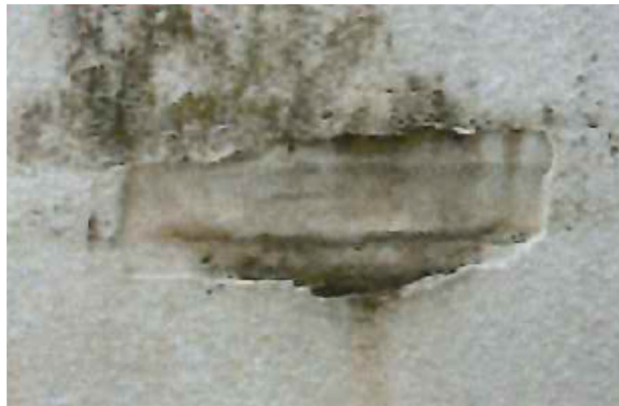
写真 10 表面被覆の剥離(1号 4-C 覆い側部)
