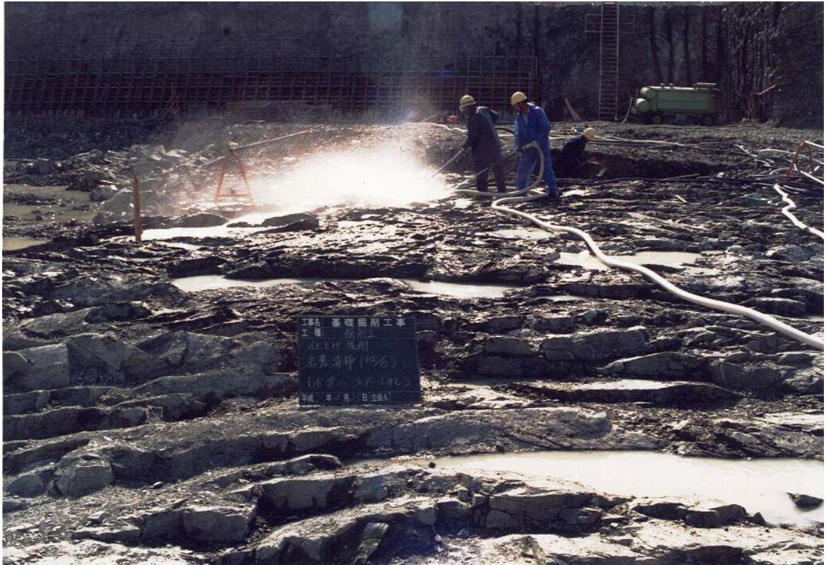
第1-1図 3号炉原子炉建屋基礎岩盤清浄状況 (平成27年3月20日審査会合資料再掲)
