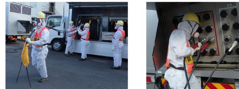
第1.0.13-4図 放射線防護具類を着用した状態での電源車のケーブル敷設作業
