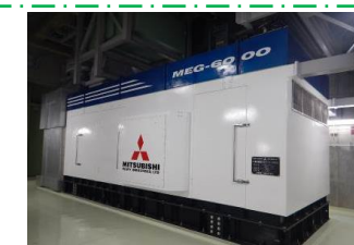
(常設代替交流電源設備の写真)
