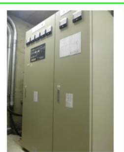
(無停電電源装置の写真)
