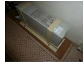
(無停電電源装置の写真)
