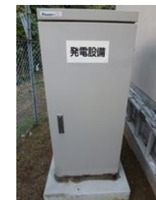
(非常用発電機の写真)
