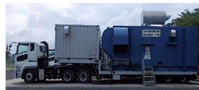
常設代替交流電源装置
