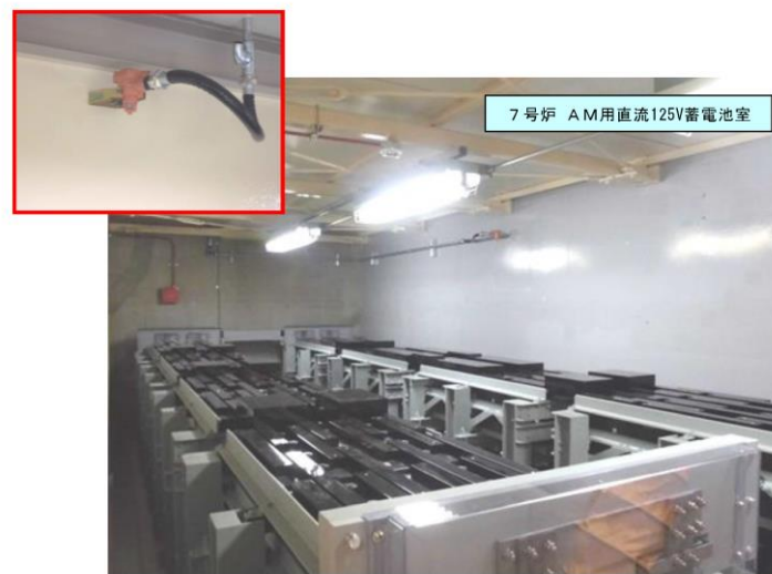
第 41-1-4 図：蓄電池室内の水素濃度検出器設置状況
