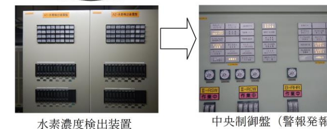
第 41-1-4 図 蓄電池室内の水素濃度検知器の設置状況
