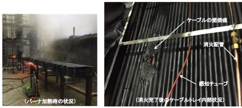
第 14 図：加熱時及び消火後の状態
