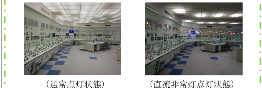
(通常点灯状態) (直流非常灯点灯状態)
