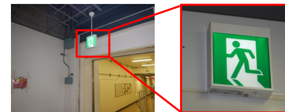
避難口誘導灯
