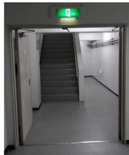
避難口誘導灯
