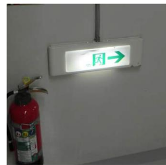
通路誘導灯 (廊下・通路)
