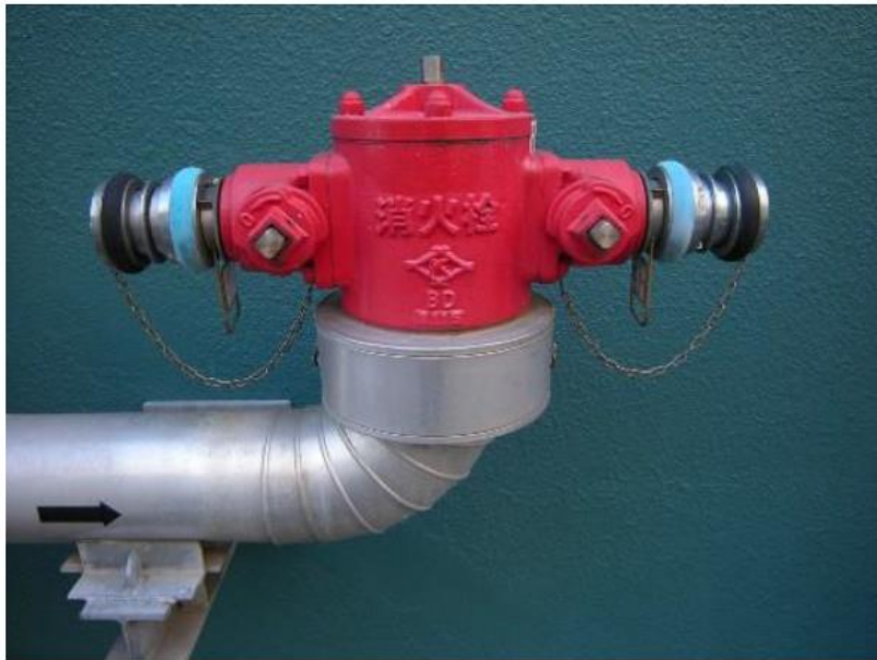
第 1-32 図：不凍式消火栓の設置状況
