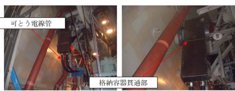
機器へのケーブル取合状況 (格納容器貫通部と電線管との取合)
