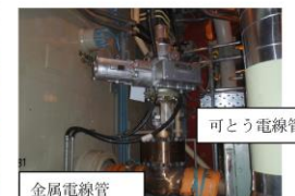
機器へのケーブル取合 (電動弁との取合)
