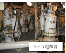
機器へのケーブル取合 (主蒸気速がし安全弁との取合)
