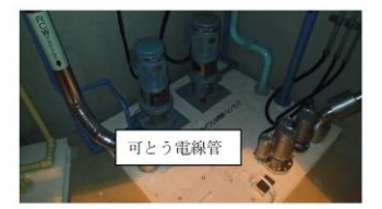
機器へのケーブル取合 (サンポンプ、レベル計との取合)
