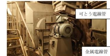
機器へのケーブル取合 (ドライウェル冷却機との取合)
