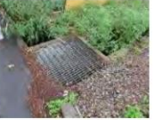
⑤-6 グレーチング
