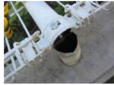
支柱部の破断
