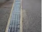
⑤-8 グレーチング
