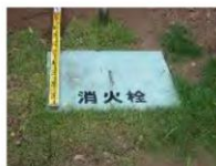
③-10 消火栓蓋
