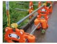
③-2 鋼製車止め (単管バリケード)
