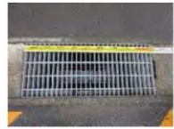
④-2 グレーチング
