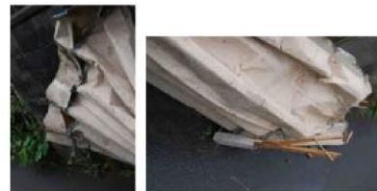
飛散した折板屋根の損傷状況
