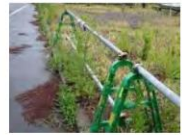
⑤-4 鋼製車止め (単管バリケード)
