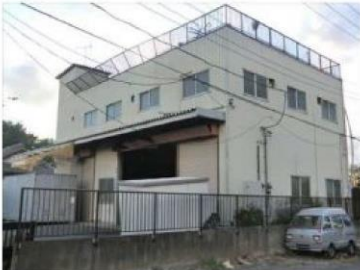
屋上フェンスの変形
