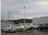
④-6 屋外照明
