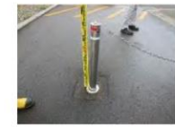
④-13 鋼製止め
