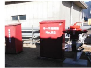
#153 消火設備格納箱
