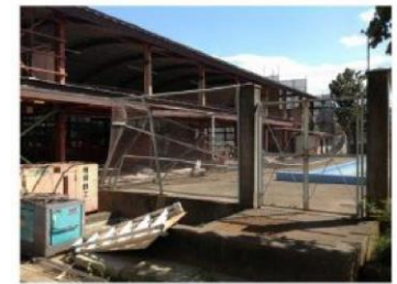
フェンスの変形 (工事中の建築物)
